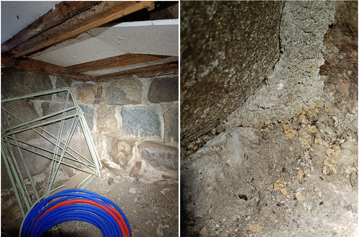
Kuva 6. Kaivokatu 8 kellarin sisätiloja (vas) ja lepakoiden papanoita kivijalan kulmauksessa (oik).
