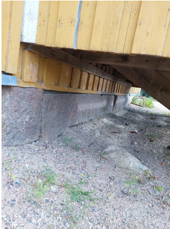
Kuva 25. Luonnonkiviperustukset ovat liikkuneet. Maanpinnan taso on alempana sisäänkäyntien kohdilla.
