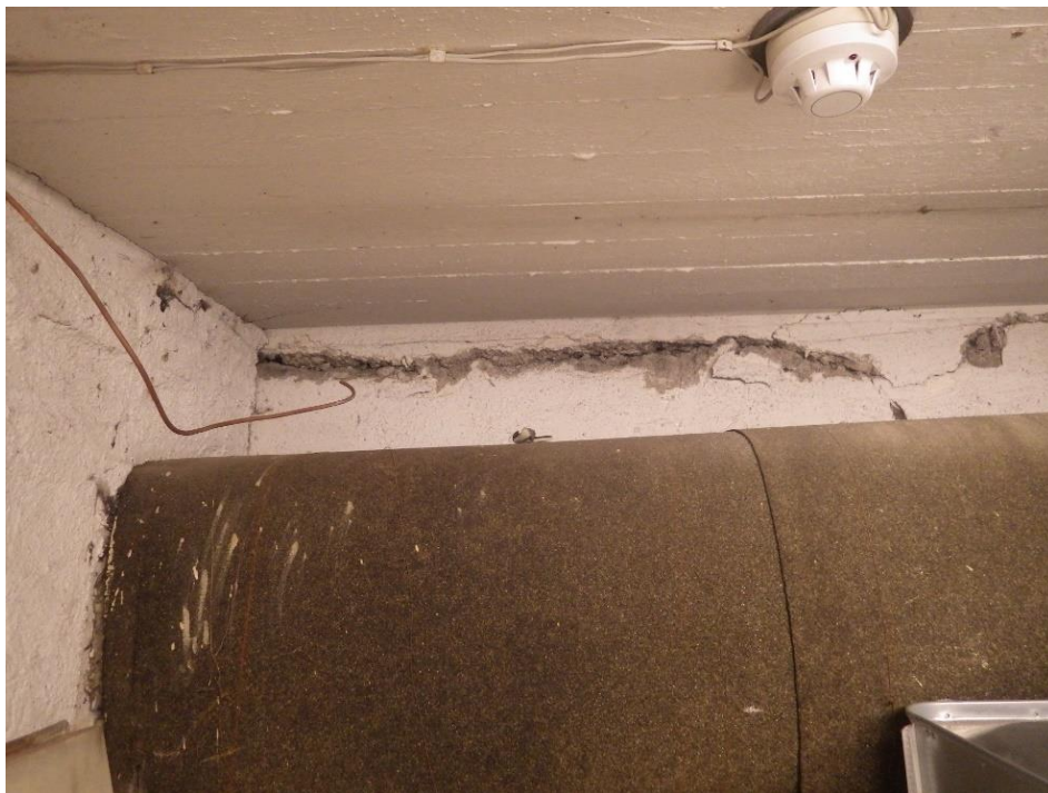
Kuva 17. Seinän yläosan halkeama oli paikoin usean sentin levyinen.
