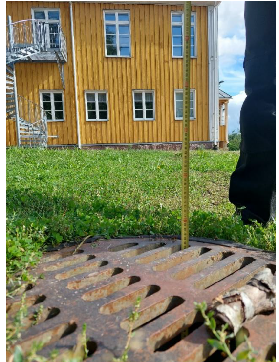
Kuva 12. Länsipuolen kattovedet ohjataan hulevesikaivoon, jossa vedenpinnan taso on lähellä kellarin lattian tasoa.
