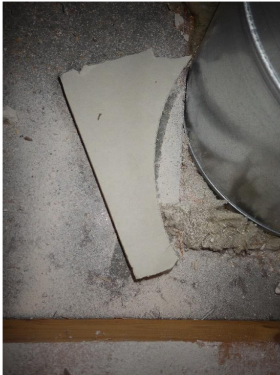
Kuva 59. IV-hormin läpivienti on tilkitty mineraalivillalla, tila 205.
