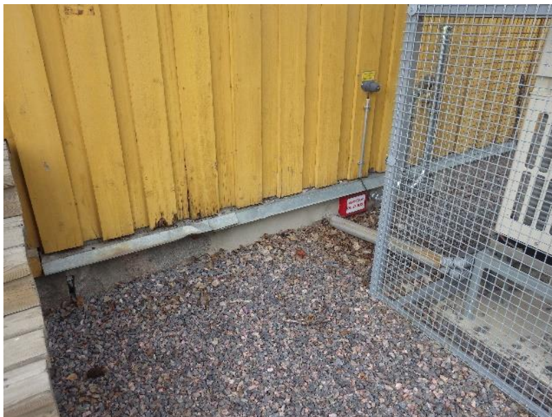
Kuva 13. Kellarin kohdalla perustukset ovat betonirakenteisia, maanpinta rakennuksen vierustalla on tasainen. Julkisivun paneloinnin alaosassa on todennäköisesti roiskeveden aiheuttamia vaurioita.
