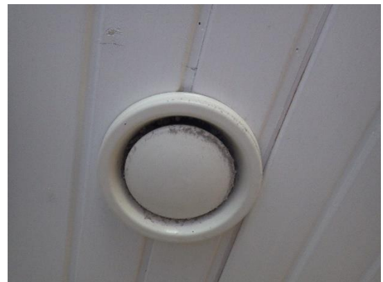
Kuva 79. Poisto-ilmanvaihdon pääte-eliimiin oli kertynyt pölyä.
