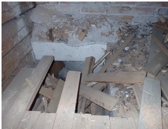
Kuva 47. Vanhassa käytöstä poistetussa kellariin johtavassa portaassa oli paljon purkujätettä.
