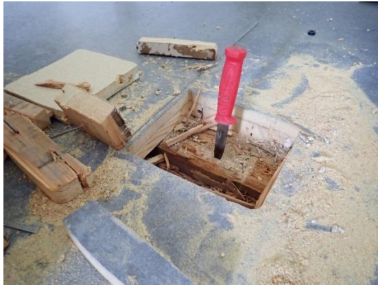
Kuva 52. Välipohjan kannatinpalkissa oli pintalahoa.
