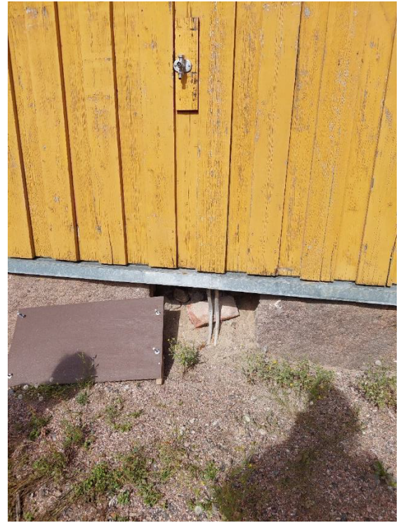
Kuva 26. WC- ja pesuhuonetilojen alueella on alapohja muutettu betonirakenteiseksi. Täyttönä on sekalaista purkujätettä, pääosin epäorgaanista purkujätettä kuten tiiltä ja laastia.
