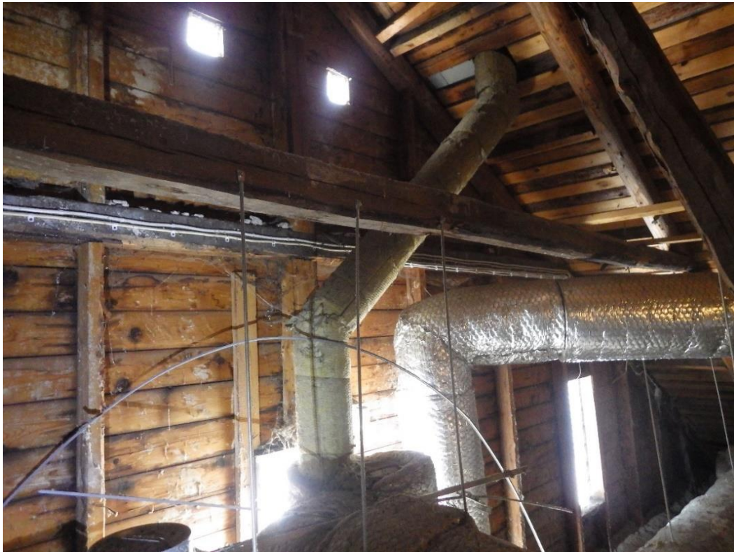
Kuva 73. Ullakon eteläpuolen ulkoseinässä oli nähtävissä kosteusjälkiä.
