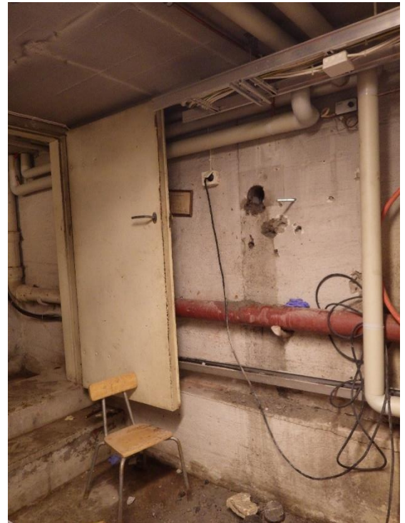
Kuva 21. Kellarin seinään tehty rakenneavaus RA10 osui kohtaan, jossa oli betonia ainakin 500 mm.
