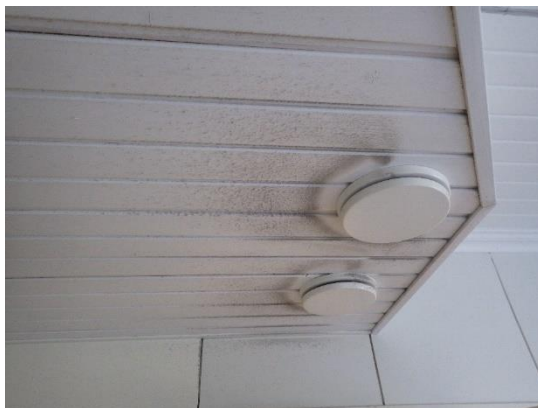
Kuva 78. Tuloilmaventtiilien ympärillä oli runsaasti pölyä.
