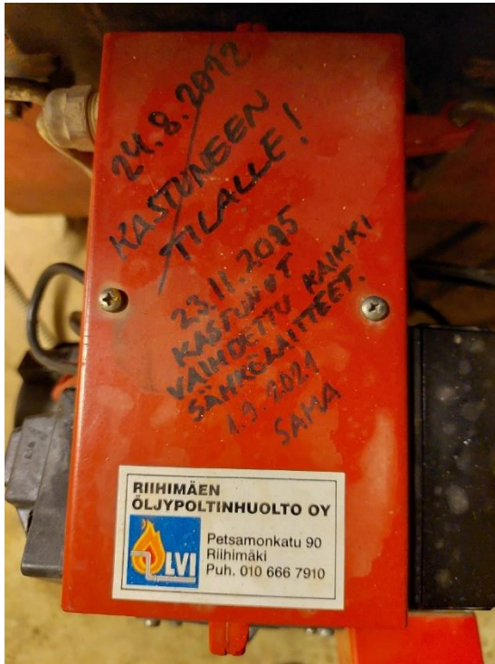
Kuva 20. Kellariin on noussut vettä useina vuosina syksyisin.
