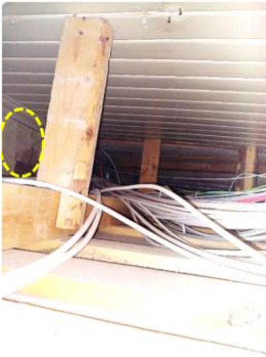
Kuva 63. Tilan 105 alakaton yläpuolella havaittiin (vanhoja) vesivuotojälkiä väliseinässä.
