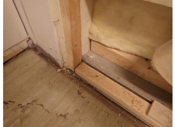
Kuva 62. Tilassa 115 oli väliseinän rakenneavauksen kohdalla vanha oviaukko. Tilan lattialla oli kosteusjälkiä ja alapohja oli painunut.
