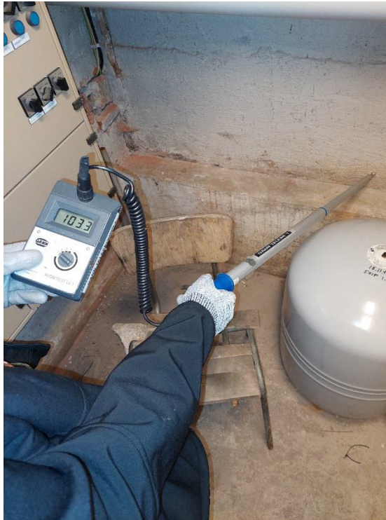
Kuva 18. Seinissä todettiin kohonneita kosteuspitoisuuksia.
