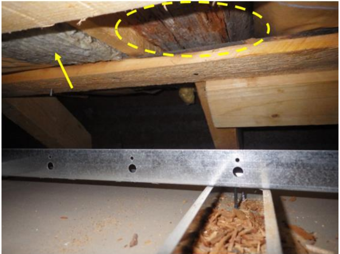
Kuva 54. Välipohjan sisältä otetussa kuvassa näkyy välipohjapalkin alapinnalla lahoa. Mineraalivillaeristeiden alla ei ole paperia kaikissa kohdissa (nuoli).
