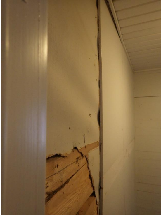
Kuva 61. Tilan 110 seinän levytykset olivat taipuneet sisäänpäin. Hirsissä ei havaittu avauskohdassa vaurioita.
