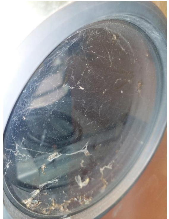
Kuva 83. Ullakon IV-koneen sisällä oli runsaasti hyönteisiä.
