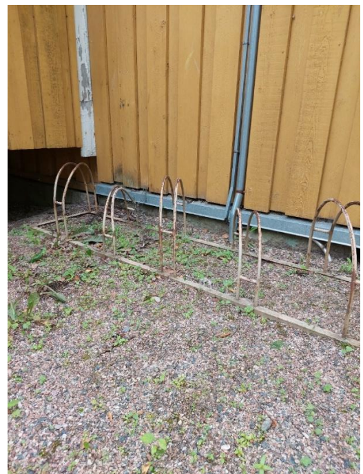
Kuva 72. Sokkeli on paikoin hyvin matala ja laudoituksen alapinnassa oli roiskeveden aiheuttamia vaurioita.
