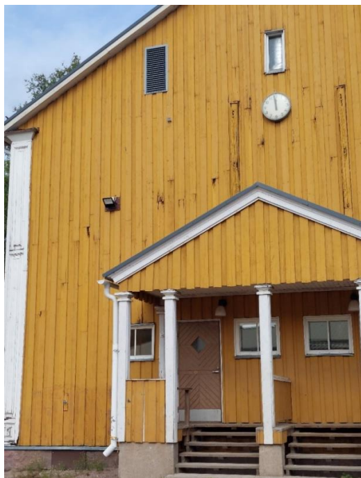
Kuva 71. Eteläjulkisivun laudoituksen jatkoskohdissa ja följareissa oli lahovaurioita.
