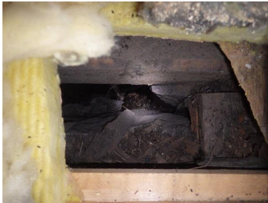
Kuva 41. Ryömintätilan nurkassa maapohja oli noin 0,5 m alempana kuin piha-alueen maanpinnan taso. Pohjalla oli runsaasti, sekalaista, osin maatonutua murea.
