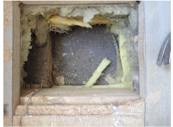
Kuva 51. Eteishallin lattia on koolattu kellarin betonirakenteisen katon päälle.
