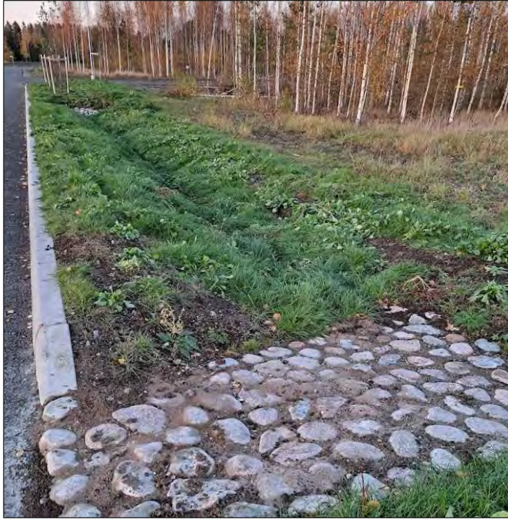
Kuva 11. Esimerkki hulevesien johtamisrakenteesta kadun viheralueella. Vesi kootaan kadulta reunakivilyn madalletusta kohdasta reunaojaan. © Destia, 2024.
