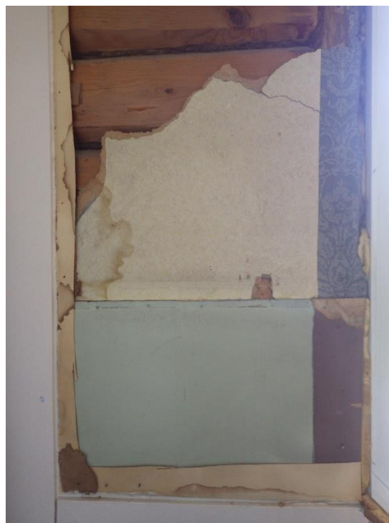
Kuva 66. Levytyksen alla oli useita tappetikerroksia, joissa oli vanhoja kosteusjälkiä.
