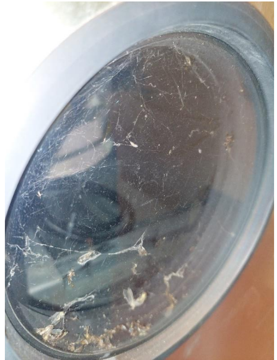
Kuva 83. Ullakon IV-koneen sisällä oli runsaasti hyönteisiä.
