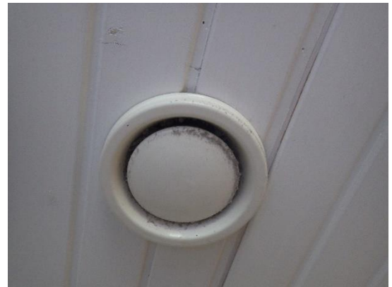
Kuva 79. Poisto-ilmanvaihdon pääte-eliimiin oli kertynyt pölyä.
