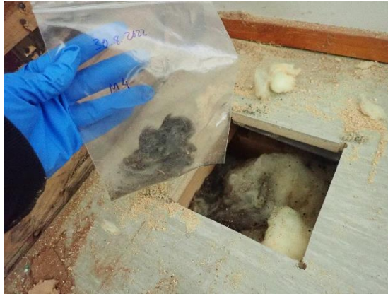
Kuva 39. Rakenteesta otetussa näytteessä M4 todettiin mikrobikasvua.
