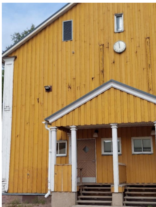
Kuva 71. Eteläjulkisivun laudoituksen jatkoskohdissa ja följareissa oli lahovaurioita.
