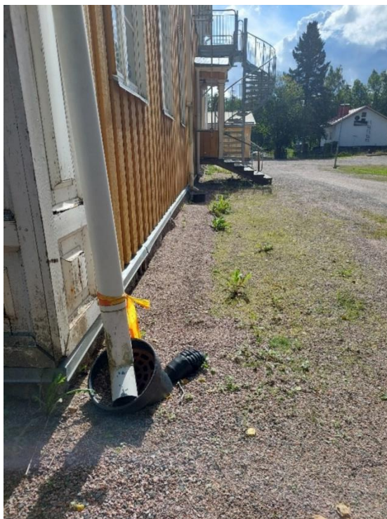
Kuva 11. Länsipuolen kattovesien ohjaus rännikaivoihin on osin puutteellinen.
