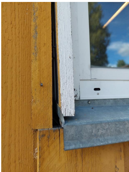
Kuva 69. Ikkunoiden ympäröivät rakenteet olivat epätiiväitä.
