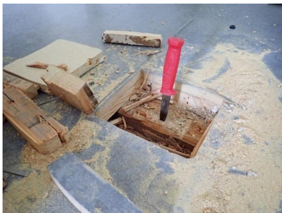
Kuva 52. Välipohjan kannatinpalkissa oli pintalahoa.
