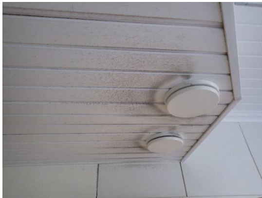
Kuva 78. Tuloilmaventtiilien ympärillä oli runsaasti pölyä.
