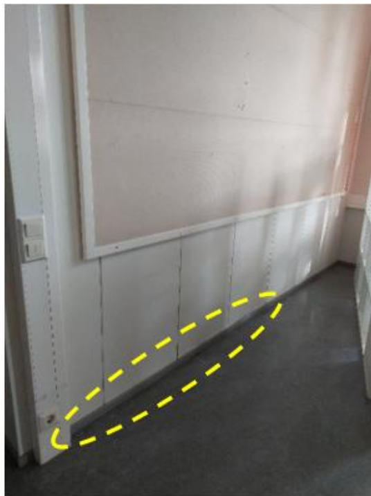
Kuva 57. Kosteuden aiheuttamia jälkiä seinän alaosassa, tila 209.
