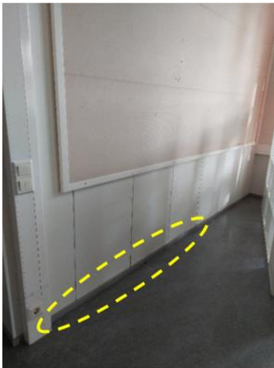
Kuva 57. Kosteuden aiheuttamia jälkiä seinän alaosassa, tila 209.
