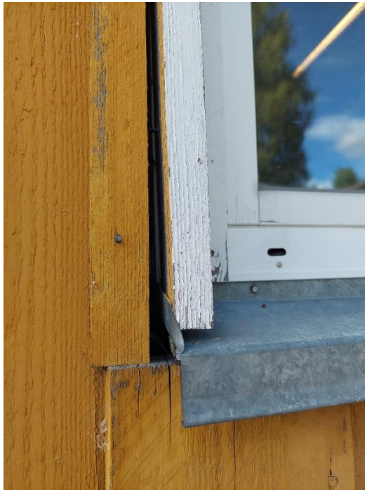
Kuva 69. Ikkunoiden ympäröivät rakenteet olivat epätiivitä.
