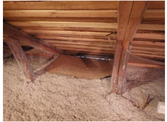
Kuva 77. Yläpohjan tuuletus on estynyt räystäältä.
