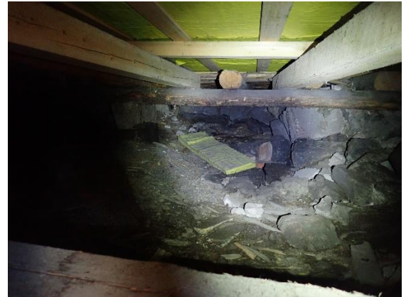
Kuva 44. Mineraalivillalevyjä oli joko pudottu tai jäänyt korjausten ajalta ryömintätilaan.
