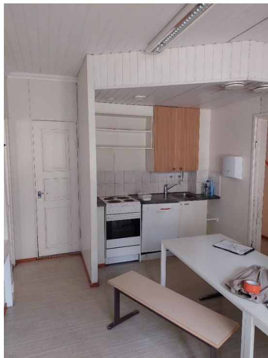
Kuva 81. 1. kerroksen keittiön yhteydessä olevan WC:n ilmanvaihto aiheutti alipainetta tiloihin.
