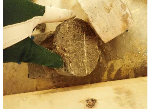
Kuva 23. Vanhan betonilaatan päälle on tehty uusi valukerros. Vanha betonilaatta haisi voimakkaasti öljylle.
