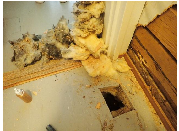
Kuva 34. Mineraalivillassa oli runsaasti tummumaa. Villakerrosten välissä oli puupurua.
