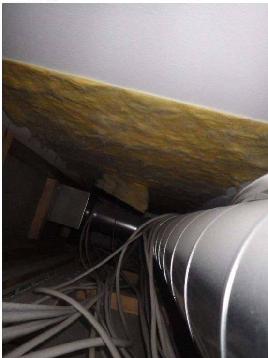
Kuva 80. Alakattotilassa on vanhoja akustiikkalevyjä, joista voi irrota kuituja.
