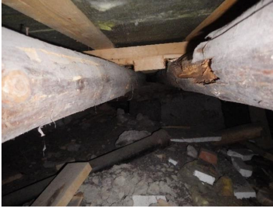
Kuva 29. Alapohjan ryömintätilaan oli jätetty paljon rakennusjätettä. Alapohjapalkeissa havaittiin lahoa.
