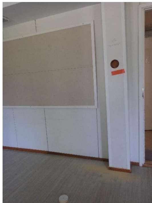
Kuva 64. Tilan 113 uusi välipohjapalkki tukeutuu vanhan väliseinän päättyyn. Seinä on kallistunut pohjoiseen päin.
