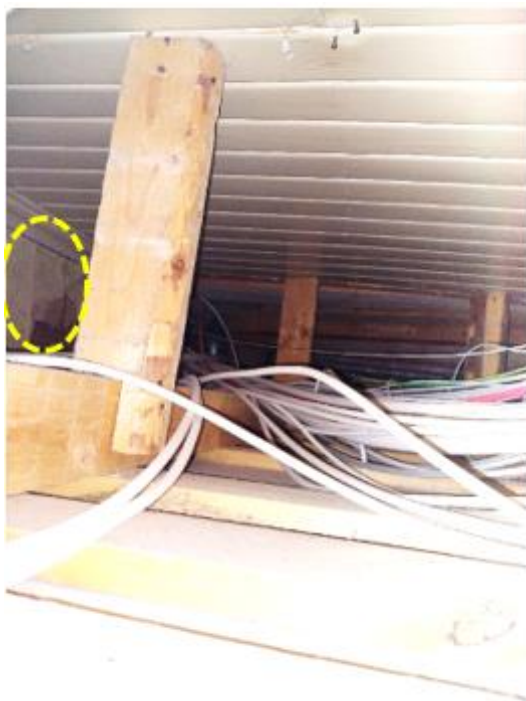
Kuva 63. Tilan 105 alakaton yläpuolella havaittiin (vanhoja) vesivuotojälkiä väliseinässä.
