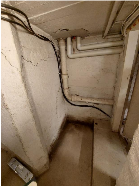
Kuva 15. Porrashuoneen seinissä oli halkeilua. Seinien alaosissa ja alapohjassa todettiin kohonneita pintakosteuden vertailulukemia.
