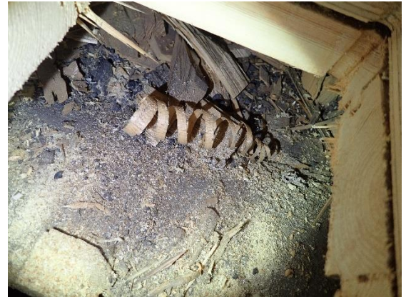
Kuva 46. Alapohjarakenteessa oli avauksen kohdalla turvetta.
