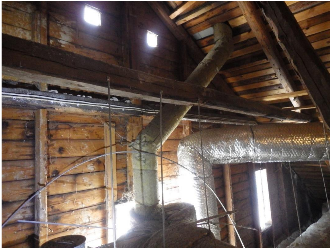
Kuva 73. Ullakon eteläpuolen ulkoseinässä oli nähtävissä kosteusjälkiä.
