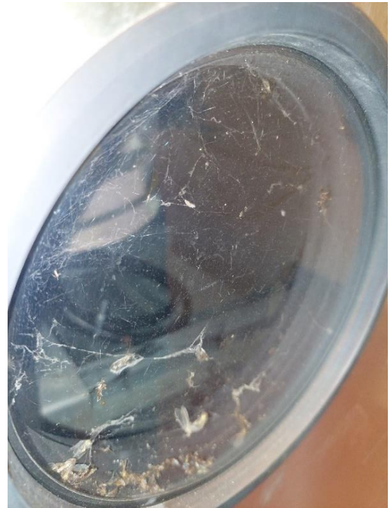
Kuva 83. Ullakon IV-koneen sisällä oli runsaasti hyönteisiä.
