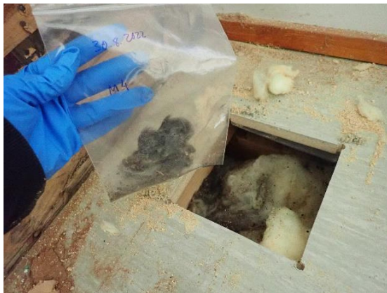
Kuva 39. Rakenteesta otetussa näytteenä M4 todettiin mikrobikasvua.
