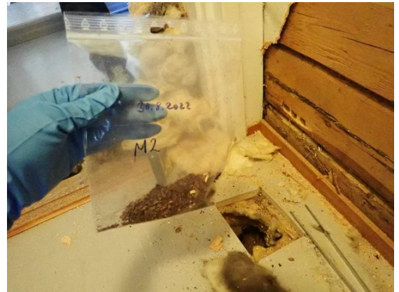
Kuva 36. Rakenneavauksesta otettiin kaksi mikrobinäytettä. M2 turpeesta ja M3 mineraalivillasta. Molemmissa todettiin mikrobikasvua.
