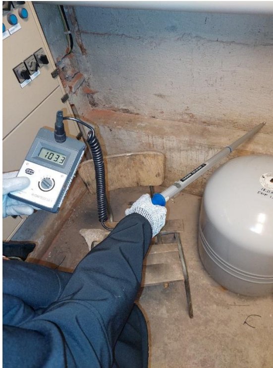
Kuva 18. Seinissä todettiin kohonneita kosteuspitoisuuksia.
