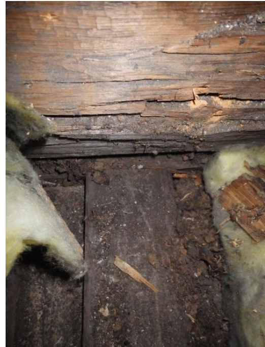
Kuva 38. Väliseinän hirsissä oli lahoa ja aluslaudoitus pehmennyt.
