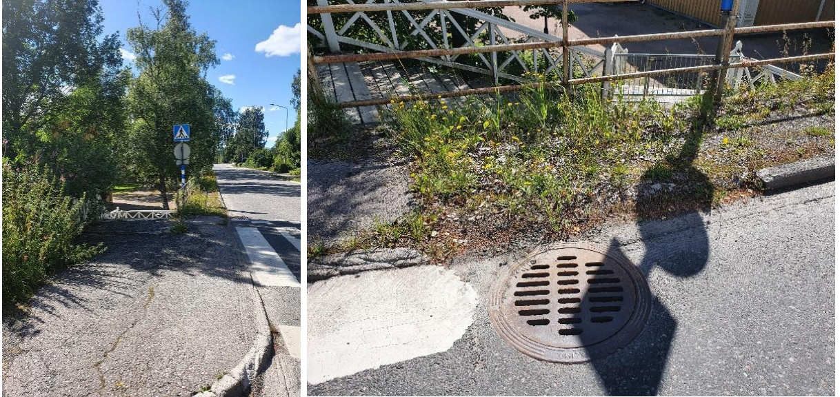
Kuva 6. Erkyläntielle muodostuu asemakaava-alueen kaakkoiskulman kohdalla notkopaikka, josta nykyisin hulevedet ohjautuvat Patastenmäen koulun kiinteistölle.
