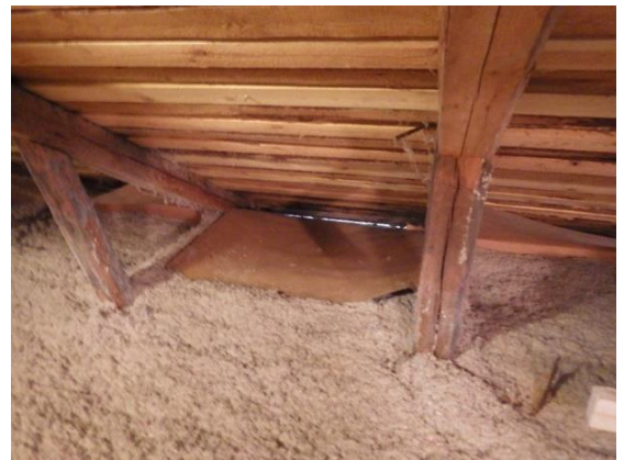
Kuva 77. Yläpohjan tuuletus on estynyt räystäältä.
