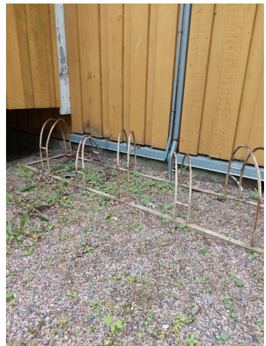
Kuva 72. Sokkeli on paikoin hyvin matala ja laudoituksen alapinnassa oli roiskeveden aiheuttamia vaurioita.
