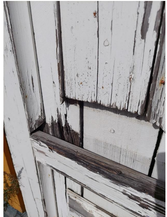
Kuva 70. Nurkkien koristepanelointien maali on kulunut pois, pinta on harmaantunut ja paikoin lahovaurioitunut.
