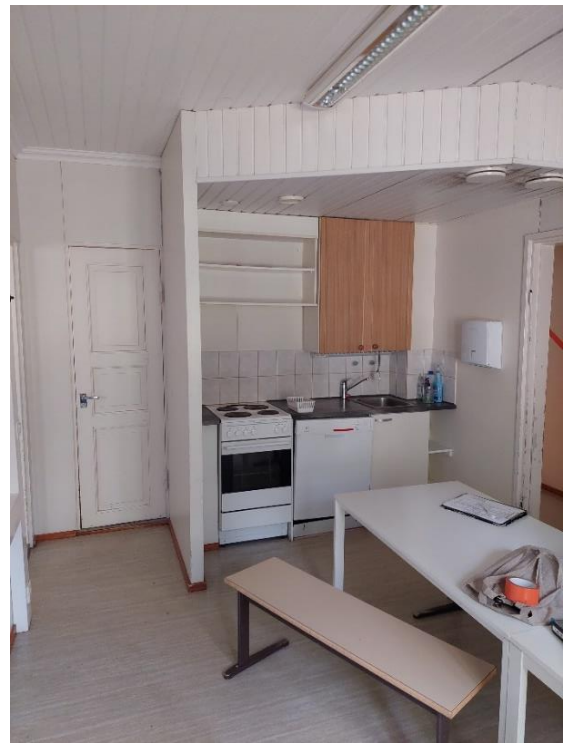
Kuva 81. 1. kerroksen keittiön yhteydessä olevan WC:n ilmanvaihto aiheutti alipainetta tiloihin.
