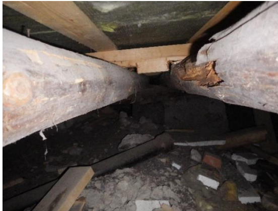
Kuva 29. Alapohjan ryömintätilaan oli jätetty paljon rakennusjätettä. Alapohjapalkeissa havaittiin lahoa.
