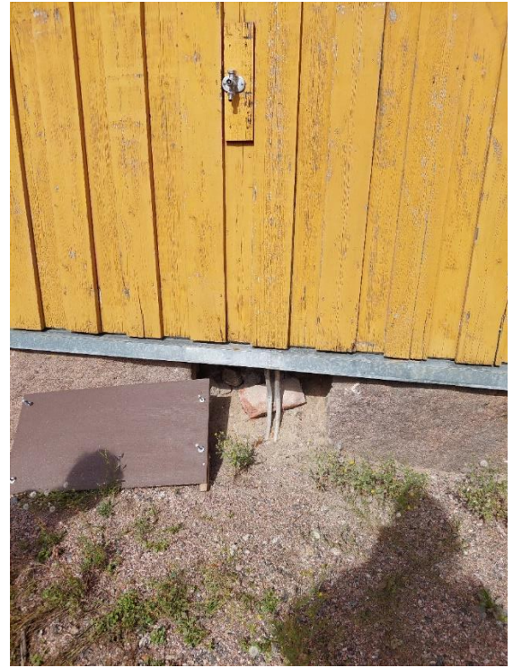
Kuva 26. WC- ja pesuhuonetilojen alueella on alapohja muutettu betonirakenteiseksi. Täyttönä on sekalaista purkujätettä, pääosin epäorgaanista purkujätettä kuten tiiltä ja laastia.
