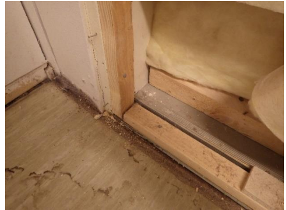
Kuva 62. Tilassa 115 oli väliseinän rakenneavauksen kohdalla vanha oviaukko. Tilan lattialla oli kosteusjälkiä ja alapohja oli painunut.
