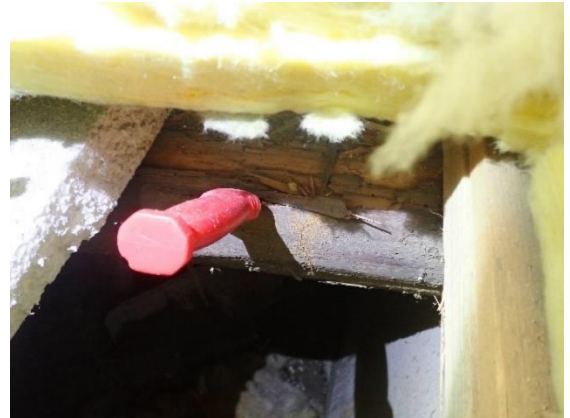
Kuva 30. Alapohjapalkki oli rakeneavauksen kohdalta pehmeä, puukon terä upposi puuhun kokonaan.
