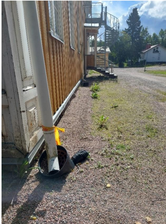
Kuva 11. Länsipuolen kattovesien ohjaus rännikaivoihin on osin puutteellinen.
