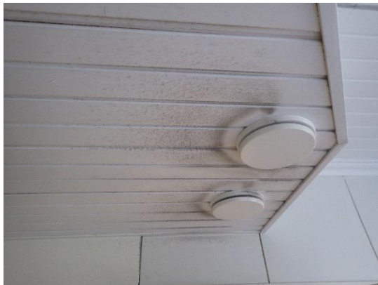
Kuva 78. Tuloilmaventtiilien ympärillä oli runsaasti pölyä.
