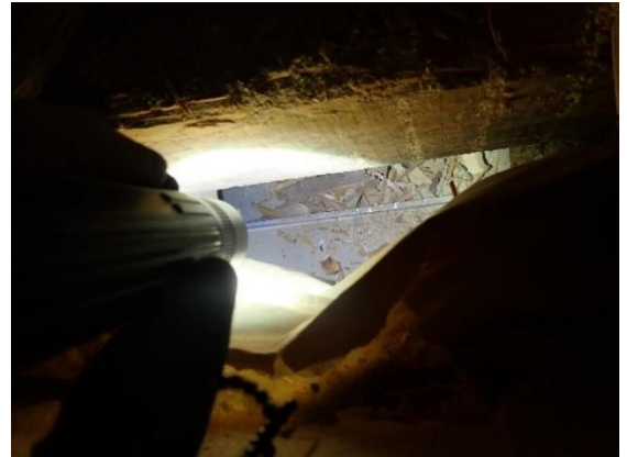
Kuva 53. Alakaton päälle oli pudonnut sekalaista materiaalia ja lahon näköistä puuta.
