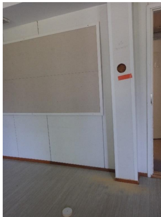
Kuva 64. Tilan 113 uusi välipohjapalkki tukeutuu vanhan väliseinän päättyyn. Seinä on kallistunut pohjoiseen päin.
