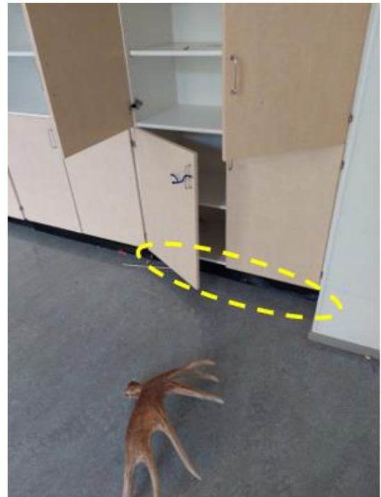
Kuva 58. Kaapin sokkelissa on kosteuden aiheuttamaa kupruilua, tila 201.
