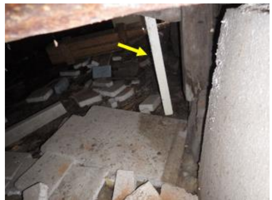
Kuva 32. Perustusten sisäpintaan asennetut EPS-eristeet olivat kaatuneet tai irti rakenteesta.
