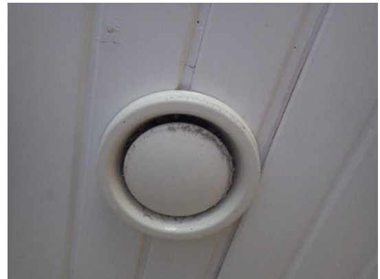
Kuva 79. Poisto-ilmanvaihdon pääte-eliimiin oli kertynyt pölyä.
