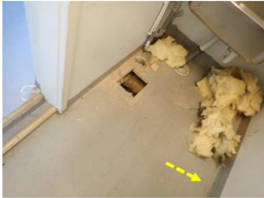
Kuva 37. Siivousskomerossa lattia vietti porrashuoneeseen päin (nuolen suuntaan). Keittiön puoleisen seinän alaosassa oli lahoa.
