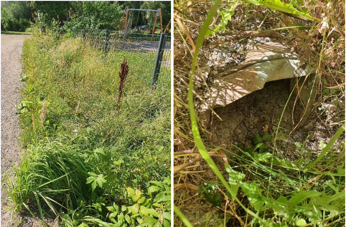
Kuva 5. Asemakaavan eteläreunassa kulkeva oja ja siihen purkava kiintoaineksestä täytynyt rumpu.
