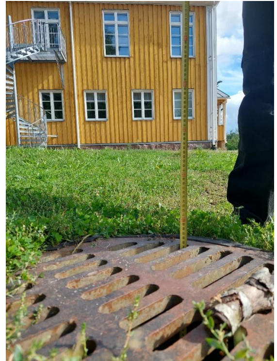
Kuva 12. Länsipuolen kattovedet ohjataan hulevesikaivoon, jossa vedenpinnan taso on lähellä kellarin lattian tasoa.
