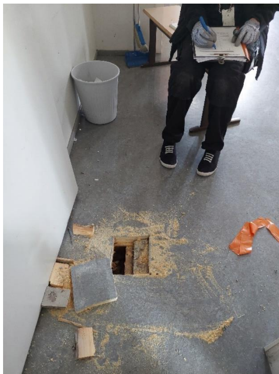
Kuva 55. Avauksen kohdalla oli välipohjassa painuma.
