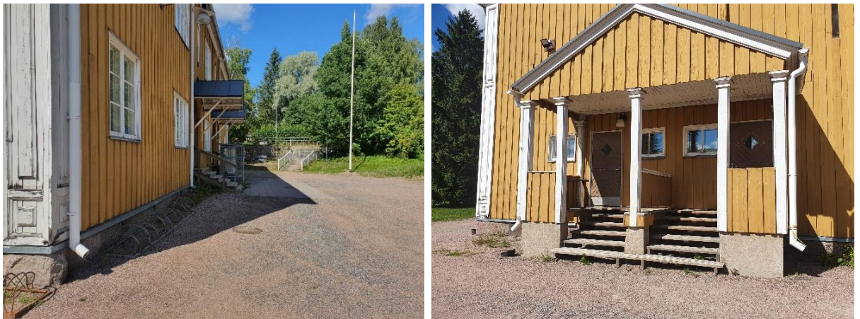
Kuva 3. Osa säilyvän kiinteistön kattovesistä ohjautuu nykyisin suoraan piha-alueelle
