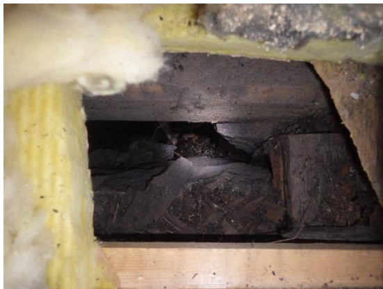
Kuva 41. Ryömintätilan nurkassa maapohja oli noin 0,5 m alempana kuin piha-alueen maanpinnan taso. Pohjalla oli runsaasti, sekalaista, osin maatunutta murea.
