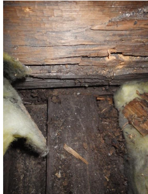
Kuva 38. Väliseinän hirsissä oli lahoa ja aluslaudoitus pehmennyt.
