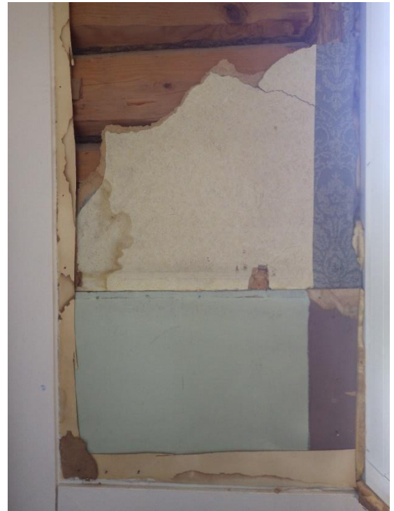
Kuva 66. Levytyksen alla oli useita ta- pettikerroksia, joissa oli vanhoja kos- teusjälkiä.
