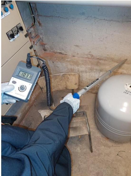
Kuva 18. Seinissä todettiin kohonneita kosteuspitoisuuksia.
