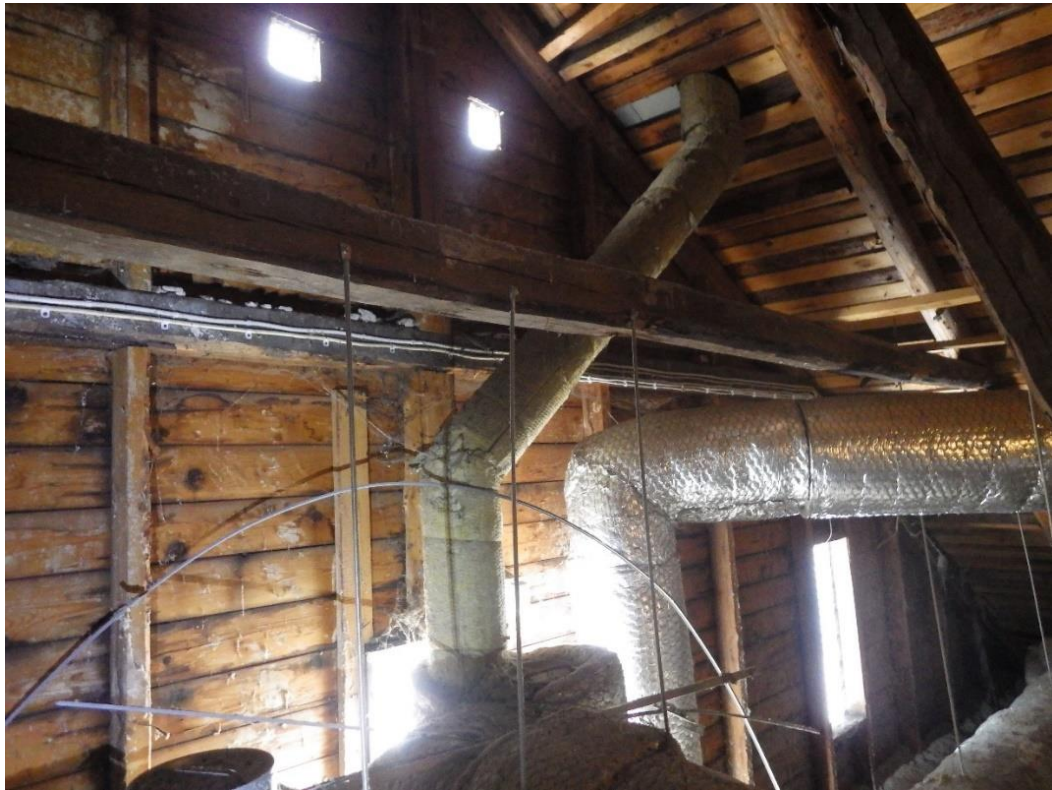
Kuva 73. Ullakon eteläpuolen ulkoseinässä oli nähtävissä kosteusjälkiä.
