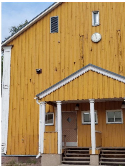
Kuva 71. Eteläjulkisivun laudoituksen jatkoskohdissa ja följareissa oli lahovaurioita.
