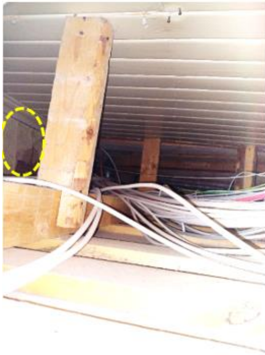
Kuva 63. Tilan 105 alakaton yläpuolella havaittiin (vanhoja) vesivuotojälkiä väliseinässä.
