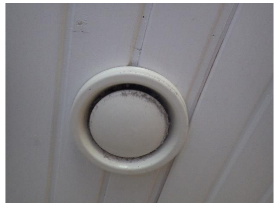
Kuva 79. Poisto-ilmanvaihdon pääte-eliimiin oli kertynyt pölyä.
