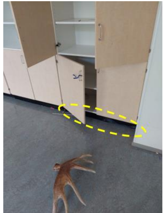
Kuva 58. Kaapin sokkelissa on kosteuden aiheuttamaa kupruilua, tila 201.
