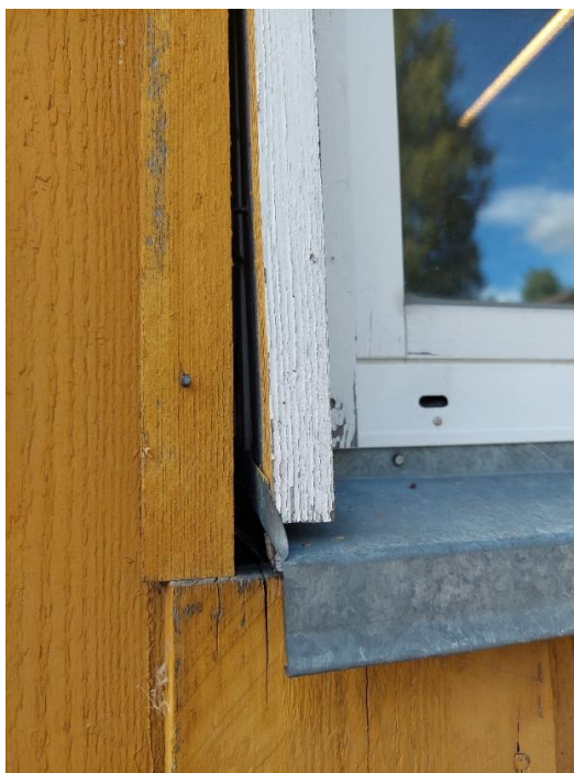
Kuva 69. Ikkunoiden ympäröivät rakenteet olivat epätiiviitä.
