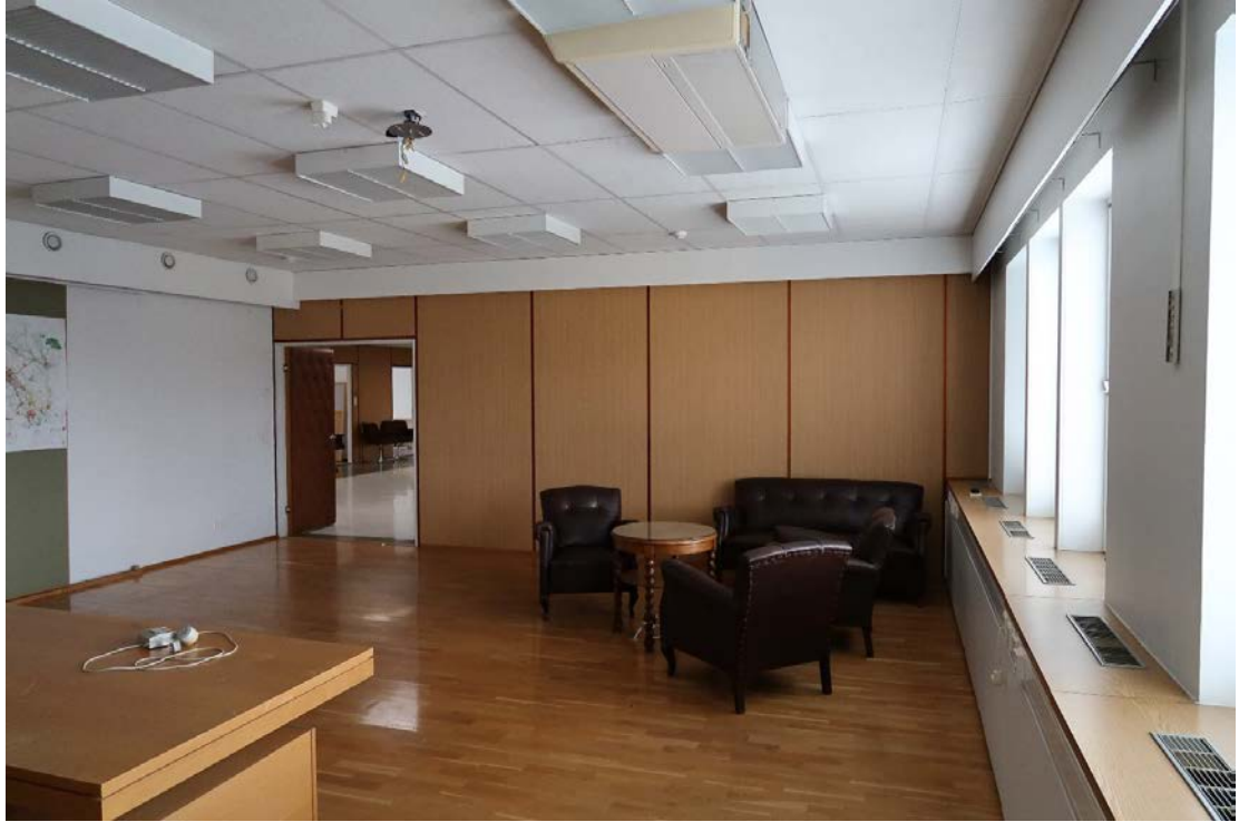
Kuva 30. Kaupunginhallituksen kokoushuone vuonna 2020. Suutinkonvektorikaapit säleikköineen ikkunaseinällä.
