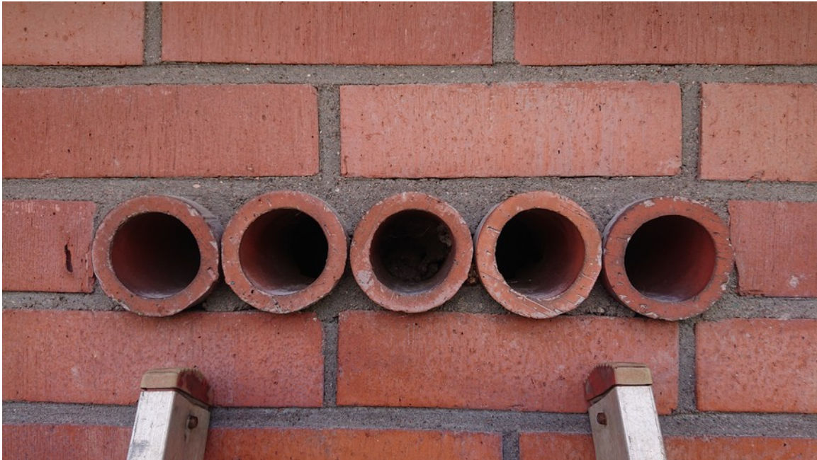
Kuva 5. Muuntajan yläosassa oli tiiliset tuuletusaukot.
