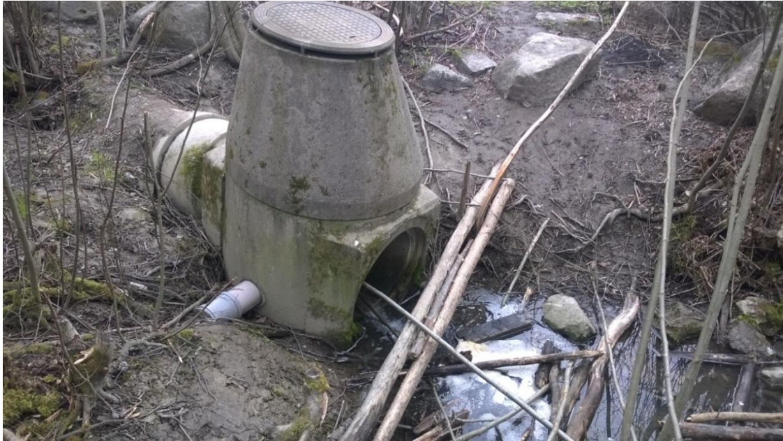
Kuva 9. Korttioniem hulevesiviemäriin purkupiste suunnittelualueen itäpuolella on kärsinyt eroosiosta
