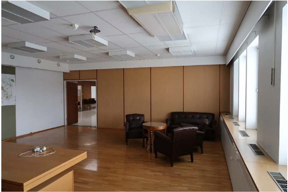
Kuva 30. Kaupunginhallituksen kokoushuone vuonna 2020. Suutinkonvektorikaapit säleikköineen ikkunaseinällä.
