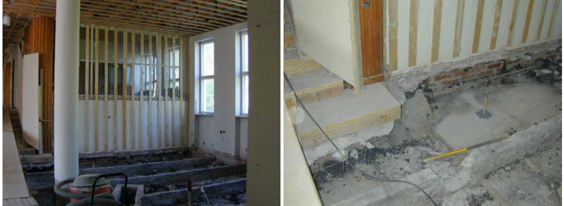
Kuva 34. Kirjastotilan alkuperäiset lasiseinät olivat vuoden 2003 korjauksen alkaessa jäljellä levytysten alla. Kirjastosalin välipohja avattiin myös kokonaan 2003 ja sen täytteet uusittiin. Kuvat Arkjaatiset Oy.
