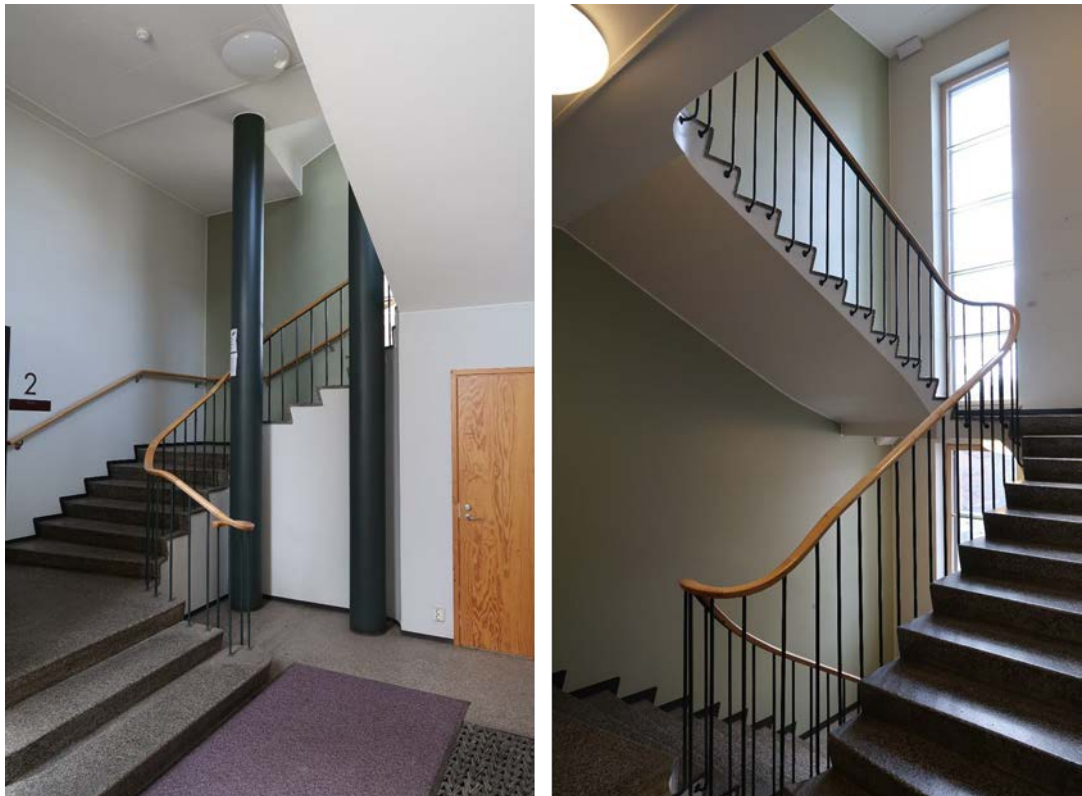
Kuva 45. Porrashuoneet ovat säilyttäneet piirteensä hyvin, tosin ovet portaikkoihin on uusittu viimeistään vuoden 2003 korjaustöiden yhteydessä. Vasemmalla kirjaston portaikko ja oikealla virastoportaikko.
