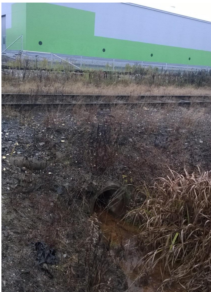
Kuva 6. Terminaalialueen sivuojan ottoputki hulevesiviemäriverkoston [Ramboll 10/2017]
